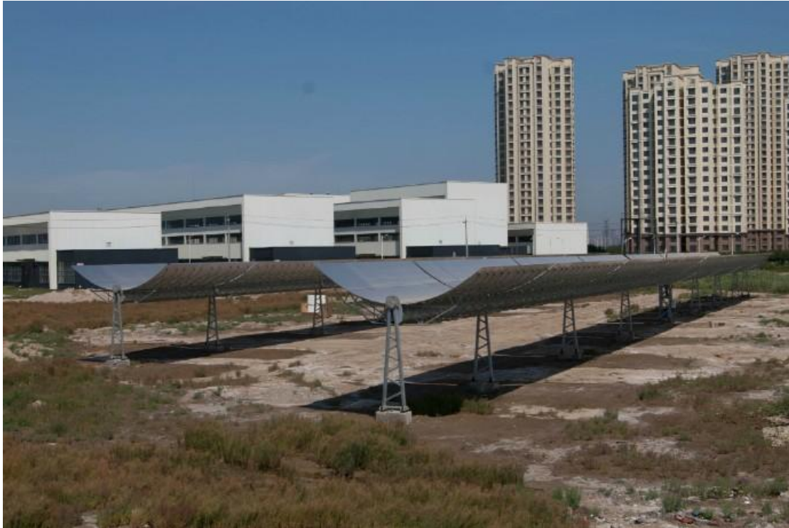
图：天津大学 200kW 级有机朗肯循环太阳能热发电技术实验基地
